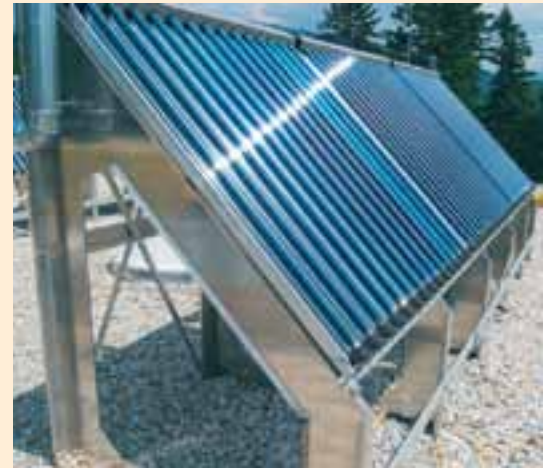
Grundrahmen in verändertem Winkel kommen oft bei Solarthermieanlagen zum Einsatz.
