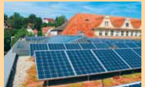
Das Dach mit Solaranlage nach der Fertigstellung.
